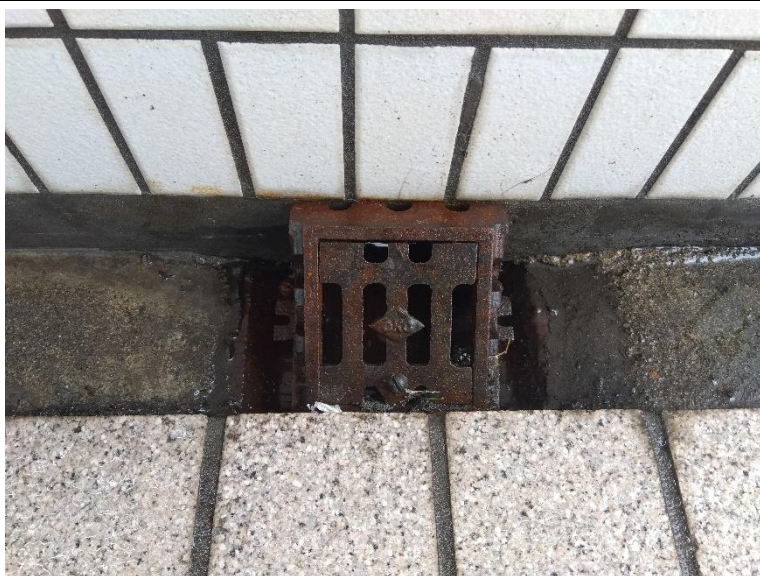
同 上(既存ストレーナー)
